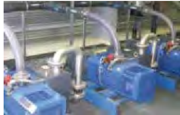
Détail de la centrale de vide
